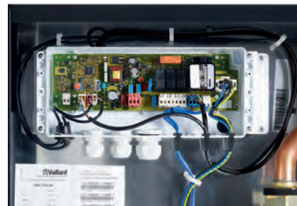
Elektrický box vonkajšej jednotky
